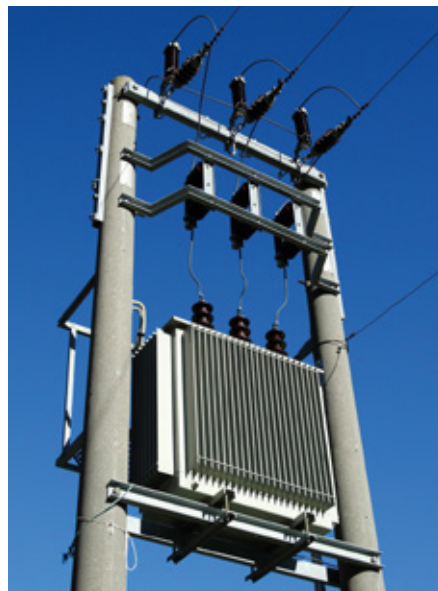
Transformador de distribución de 160KVA instalado en un biposte.
